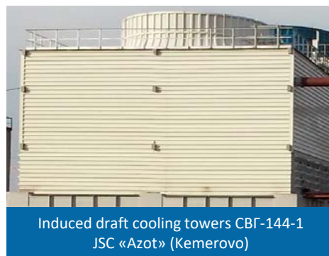
Вентиляторная градирня СВГ-144-1 Кемеровское АО «Азот»
