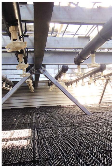
Подвесная ВРС СВГ-144-2. Клинская ТЭЦ Suspended water distribution system on Klin CHPP
