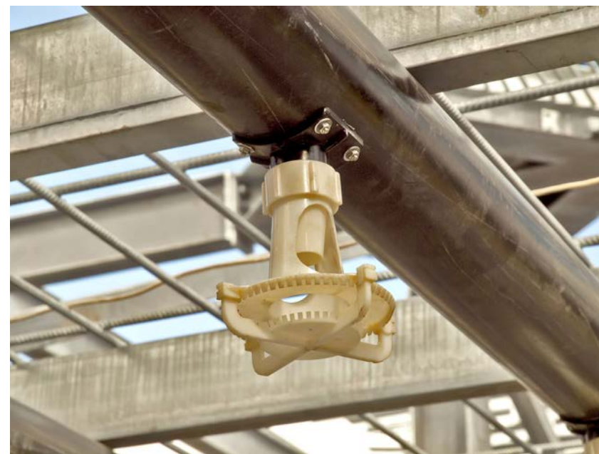
Сопло СР-2Т, установленное в градирине СВГ-144-2
