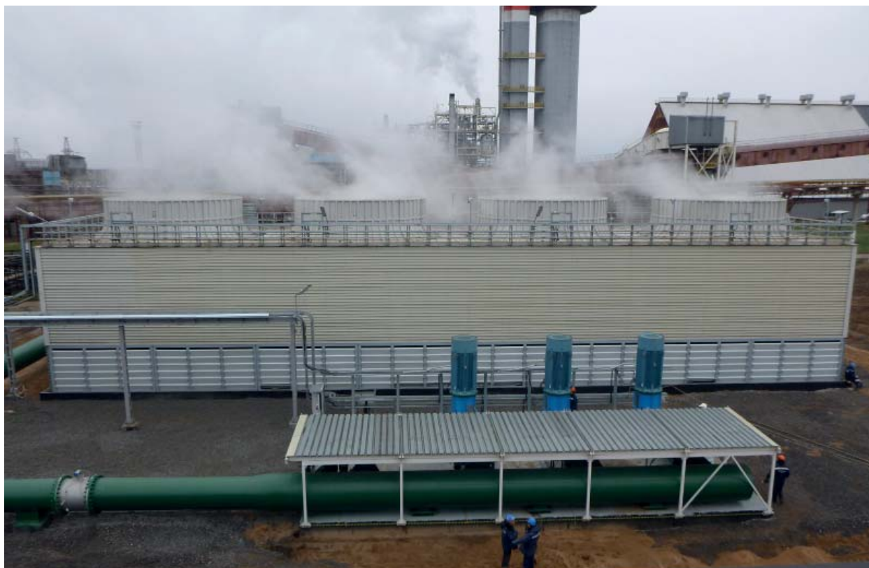
Сборная вентиляторная градирня СВГ-100-4. Насосная станция с полупогружными насосами.
