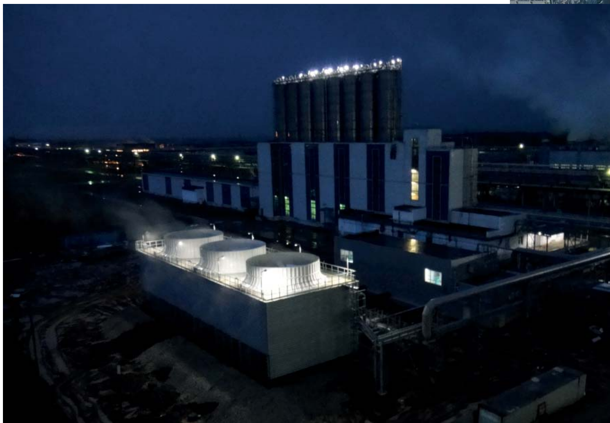
Блок системы оборотного водоснабжения
