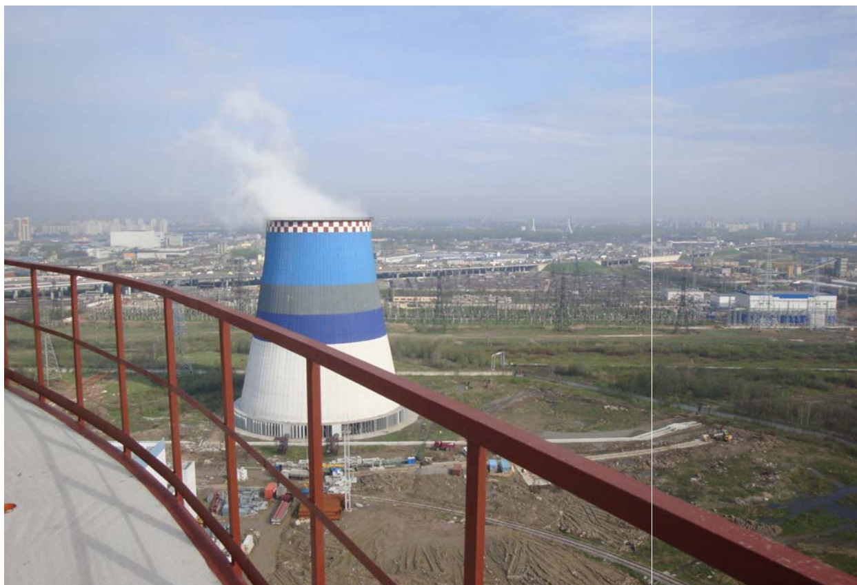
Башенная градирня ст. №2 (поставка оборудования 2007-2008 гг.)
